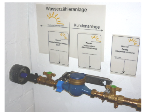
Bild 3: Wasserzähleranlage bis QN 10
